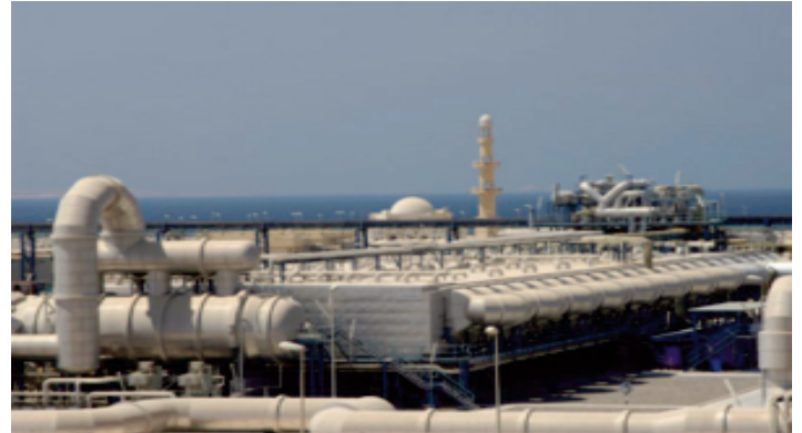
Meerwasserentsalzungsanlage des Gas-und Dampfturbinen (GuD)-Kraftwerks Shuweihat, Vereinte Arabische Emirate
